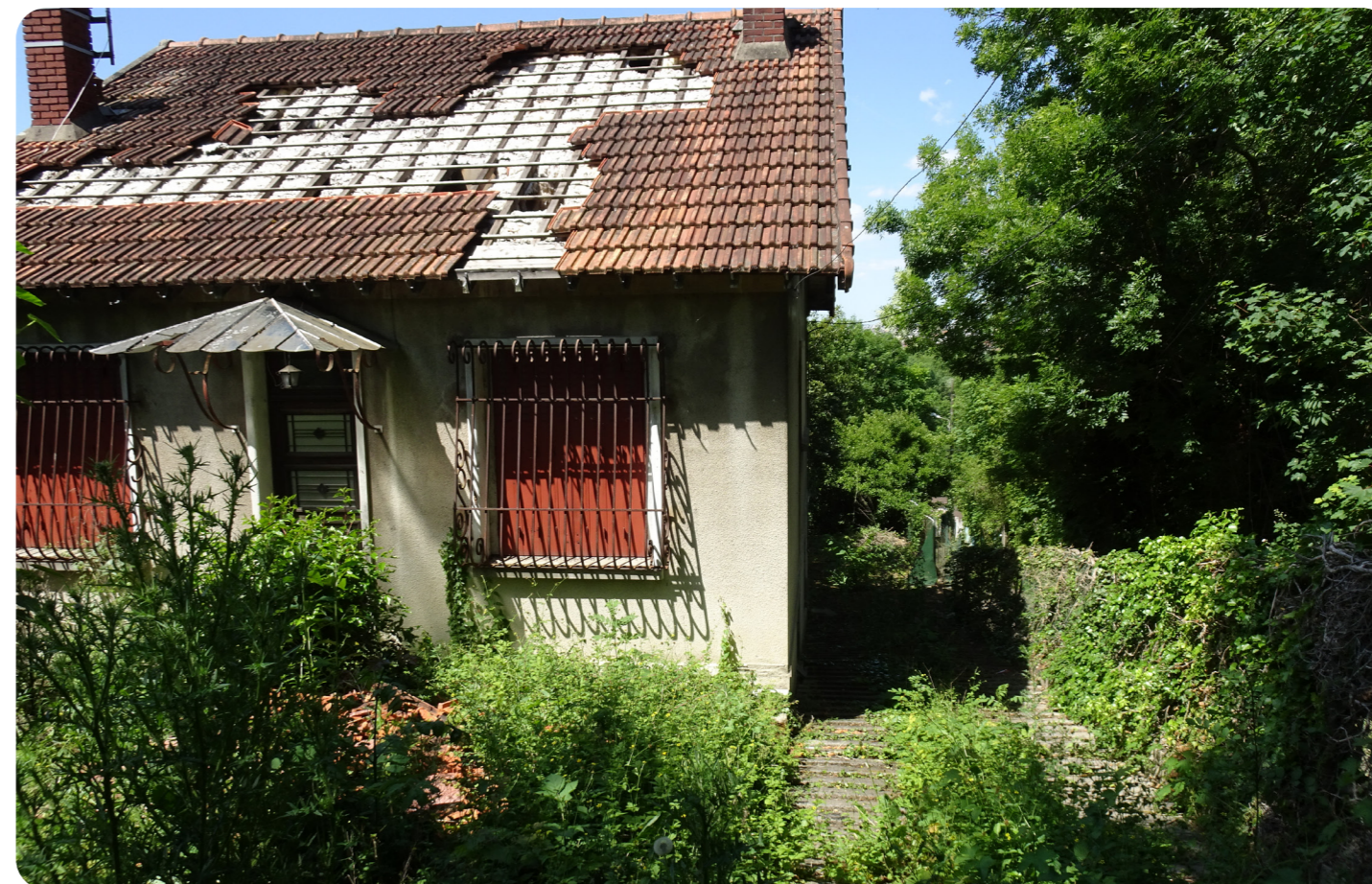
Habitat dégradé (source TRANS-FAIRE, 2022)
